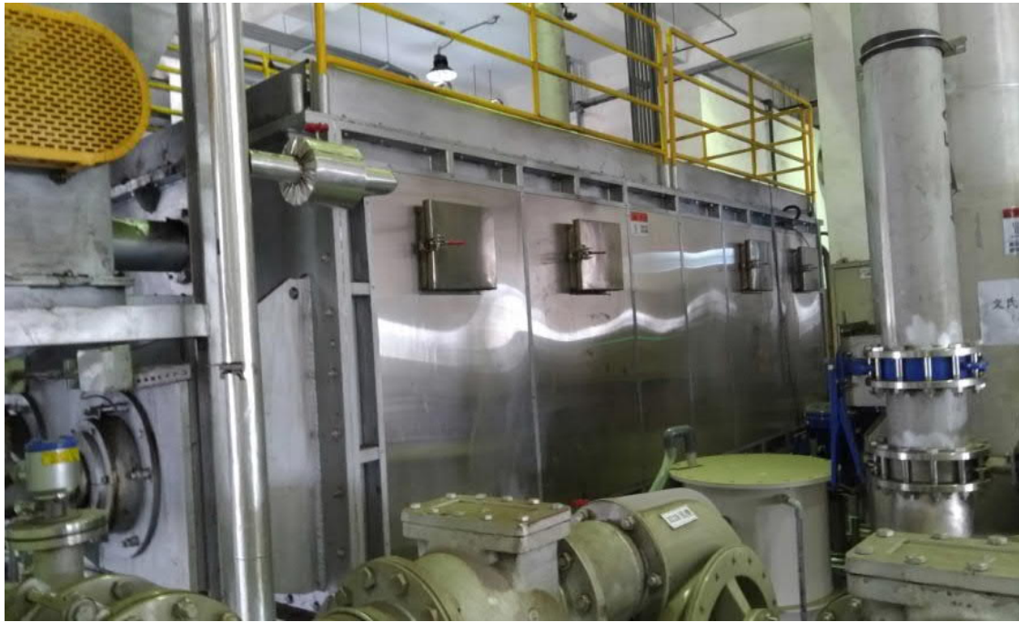
圖 3-8、福田污水處理廠污泥乾燥設備
