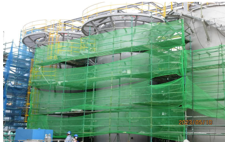
圖 3-15、廢溶劑（異丙醇）純化設施-（建廠中）
